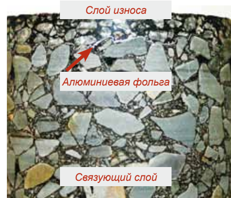
Структура покрытия, уложенного по технологии Компакт-асфальт за один проход асфальтоукладчика. Алюминиевая фольга проложена для более наглядной демонстрации границы между слоями.
